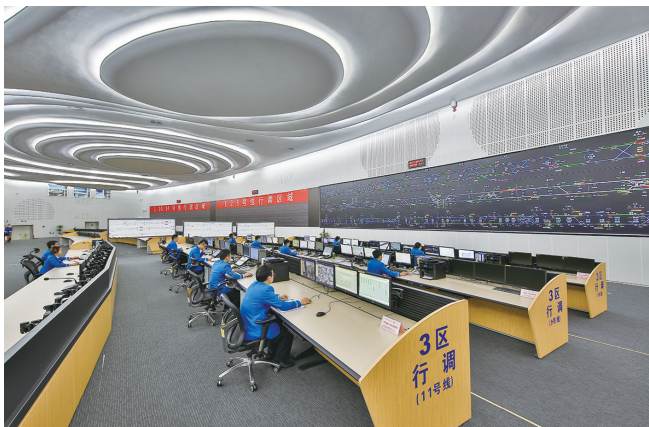
深圳市轨道交通网络运营控制中心(NOCC)
