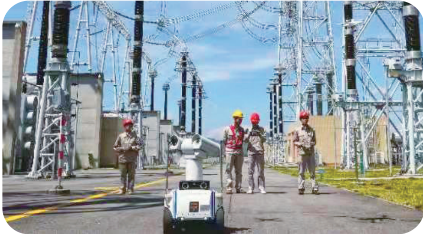
国网福建省电力有限公司在福建1000千伏特高压榕城变电站内，实施世界首次1000千伏变电站无人机多机协同自主巡检
