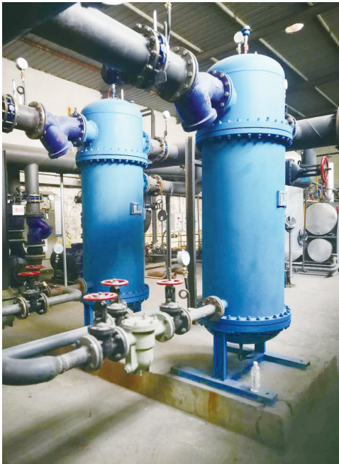
供热站换热系统
