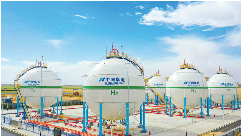
内蒙古华电包头市达茂旗20万千瓦新能源制氢工程示范项目储氢罐
