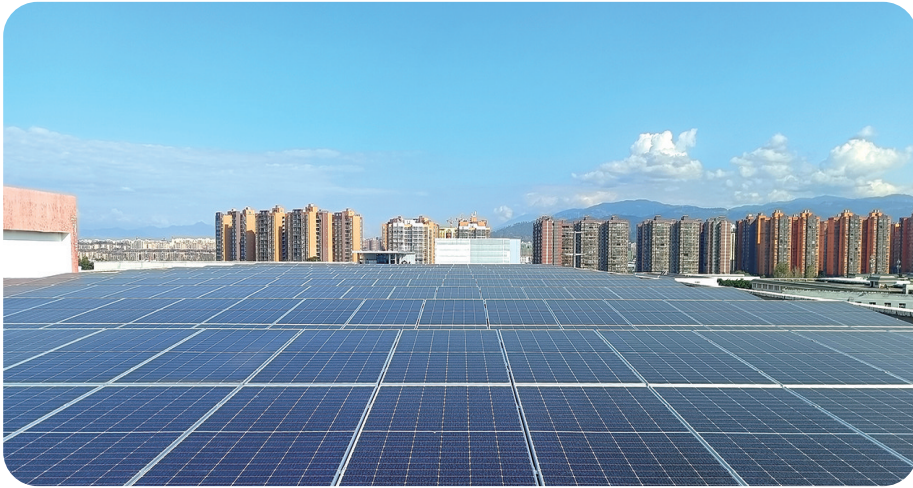
公司在西昌厂建成首个分布式屋顶光伏项目
