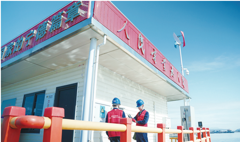
国家电网福建电力“双满意”共产党员服务队对海上充电设备进行检查
